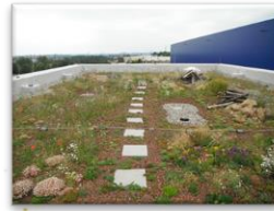
Extensive Dachbegrünung mit Totholzstrukturen
